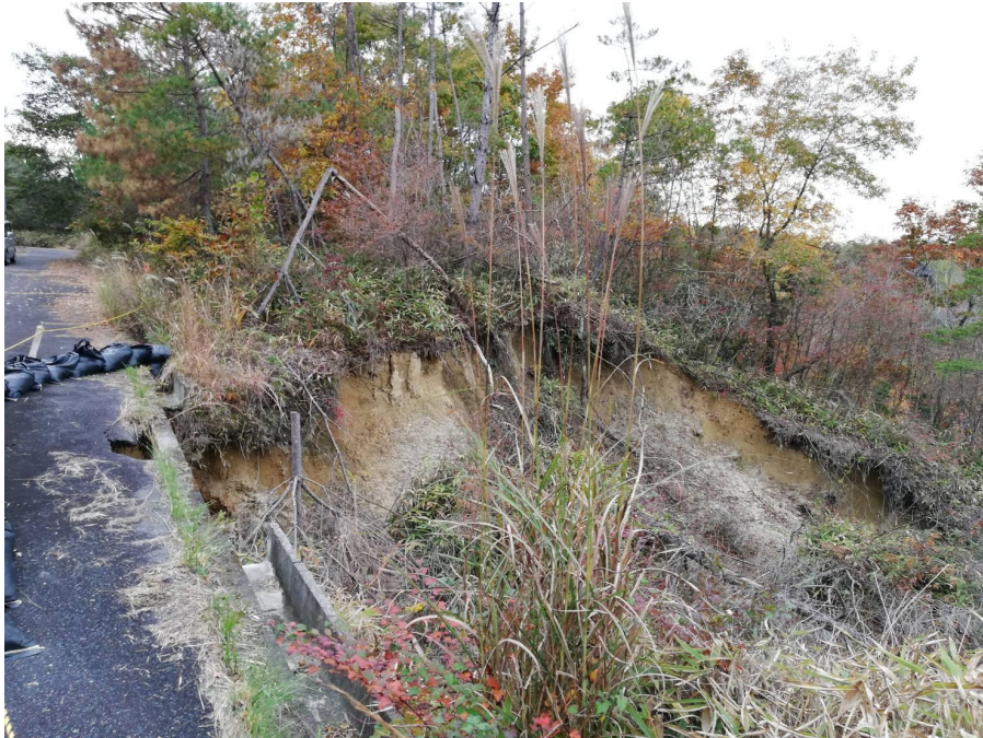
土砂崩れの起きそうな 崖地
